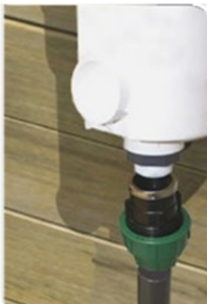
Descente rigide sous skimmer
